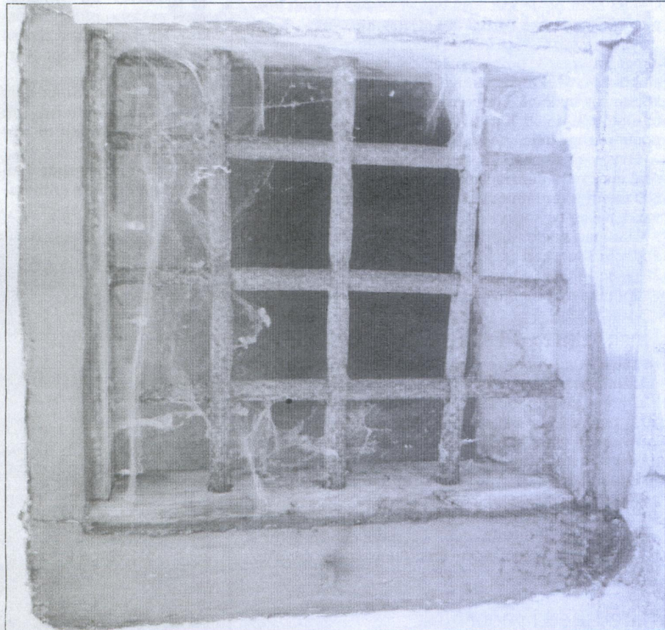
På kirkens sydside er der et glughul i soklen ved gravstedet, men det er lukket med tykke, rustne jernstænger.
